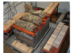
Transformer repair in the untanking room Reparación del transformador en depósito de descubierto
